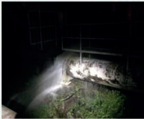
Şekil 5.2.4. Kumamoto Depremi sırasında 800 mm çaplı bir borunun birleşim noktasında meydana gelen sızıntı (Wham ve diğ., 2017)
