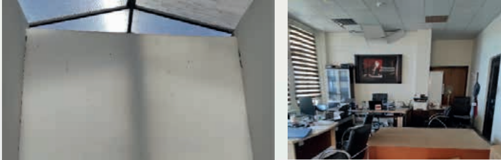
Şekil 3.56. Kalkan duvar düşme tehlikesi ve asma tavan hasarı
