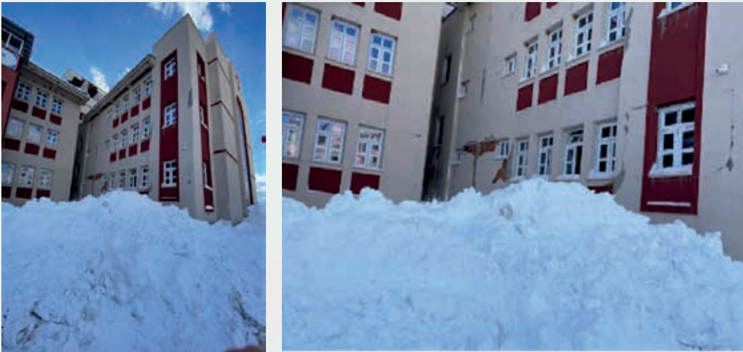
Şekil 3.26. Şehit Mesut Çelik İlkokulu ve Ortaokulu, dış cephe duvarlarında oluşan hasarlar
