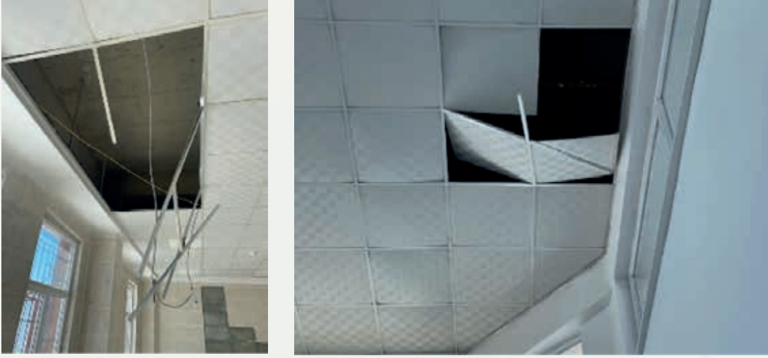
Şekil 3.24. Okul ve pansiyon binalarında oluşan yaygın asma tavan hasarlarına iki örnek
