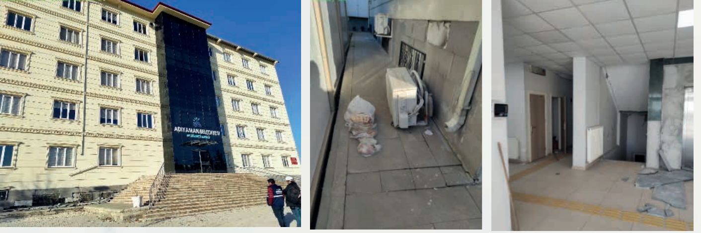
Şekil 3.54. Ek Bina ve zeminde oturma, merdiven hasarı
