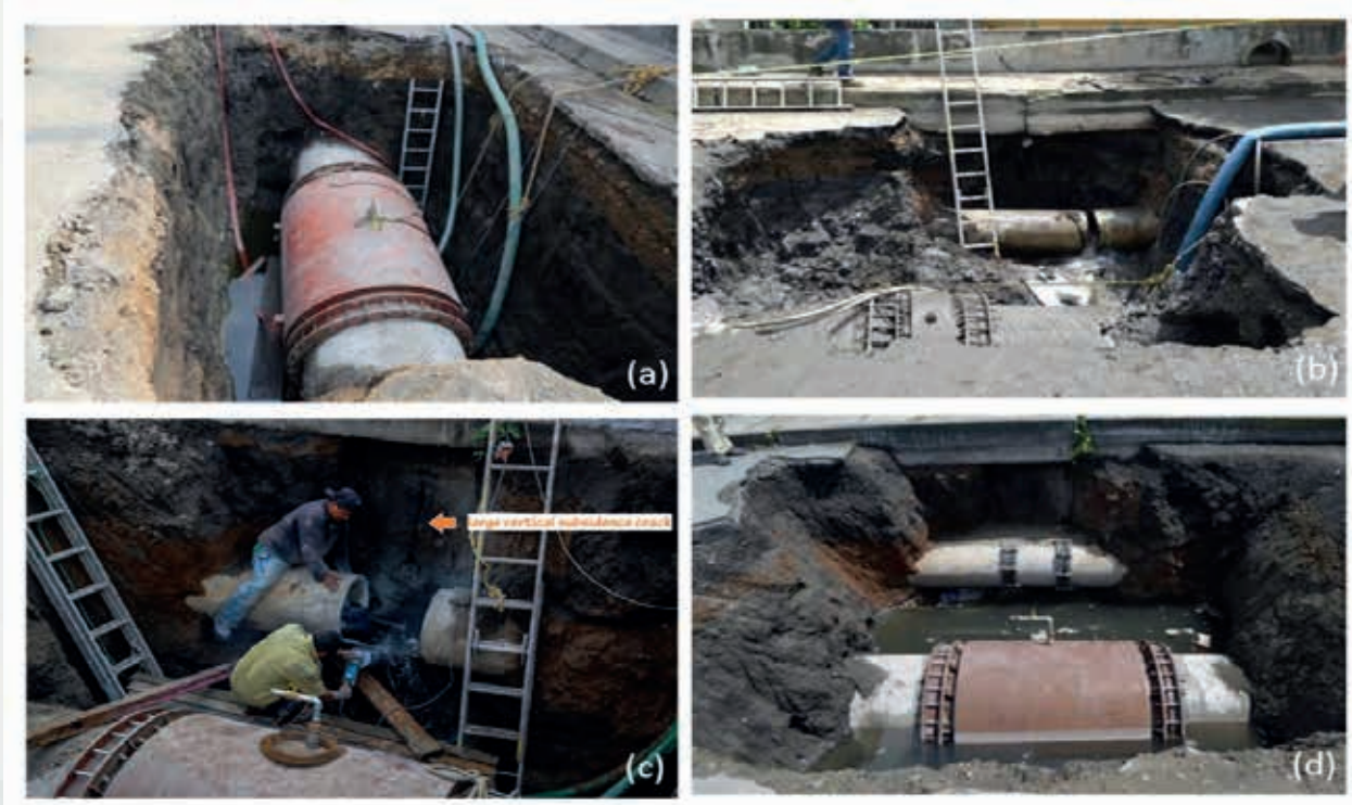
Şekil 5.2.5. Mexico City’deki Colonia Del Mar bölgesinde yaygın olarak görülen boru hattı hasarları ve onarımı (Lemnitzer ve diğ., 2021)
