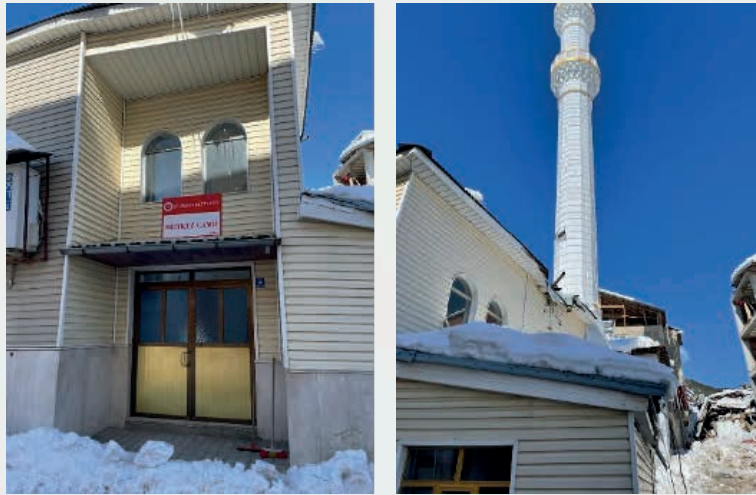
Şekil 3.62. Merkez Cami ve hasarlı minaresi
