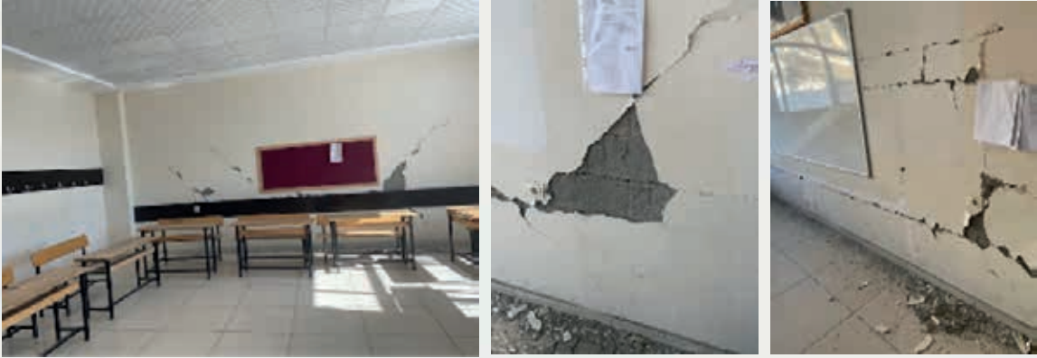
Şekil 3.22. Çelikhan Ortaokulu binası bölme duvarlarında oluşan çatlaklar ve sıva dökülmeleri
