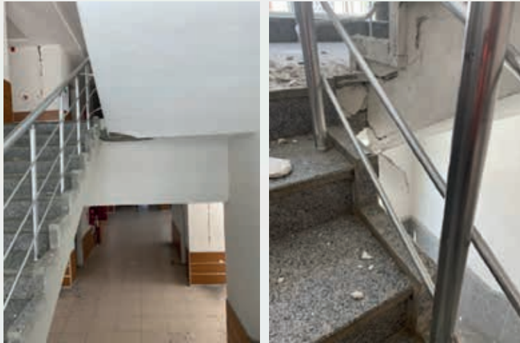
Şekil 3.23. Çelikhan Ortaokulu binası merdiven sisteminde oluşan yapısal hasarlar ve merdiven kaplamalarındaki hasarlar
