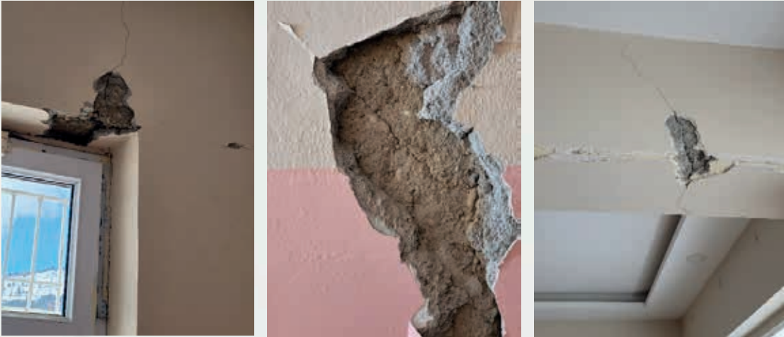
Şekil 3.28. Çelikhan Şehit Seyho Anadolu Lisesi betonarme binasında kiriş ve kolon mesnet bölgesi civarında görülen diyagonal kayma çatlakları
