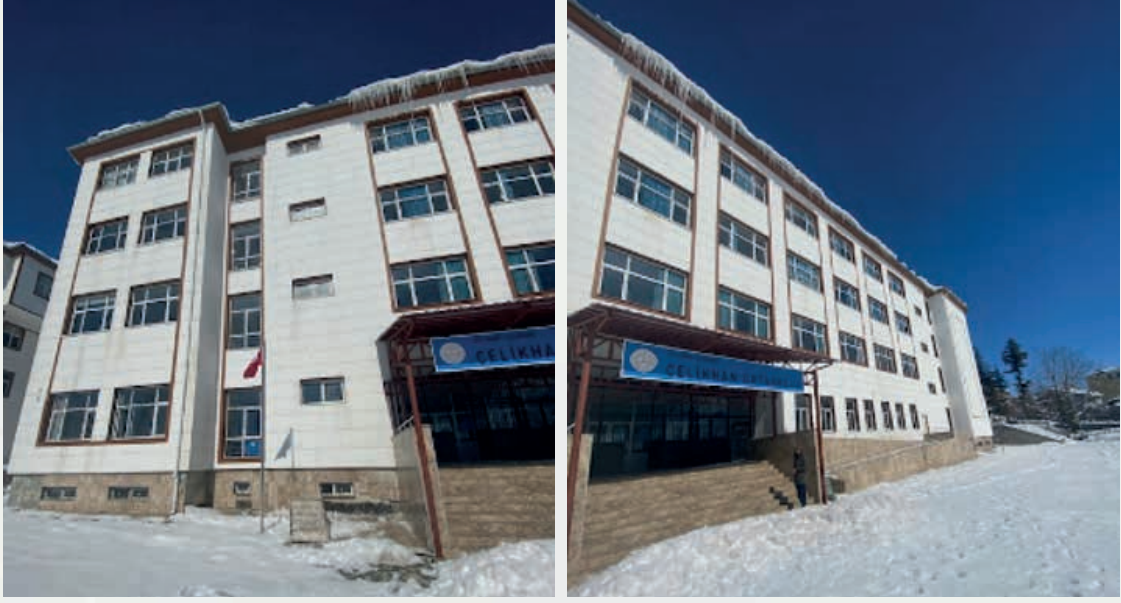
Şekil 3.21. Çelikhan Ortaokulu binası, dış cephe kaplamalarında oluşan dökülmeler
