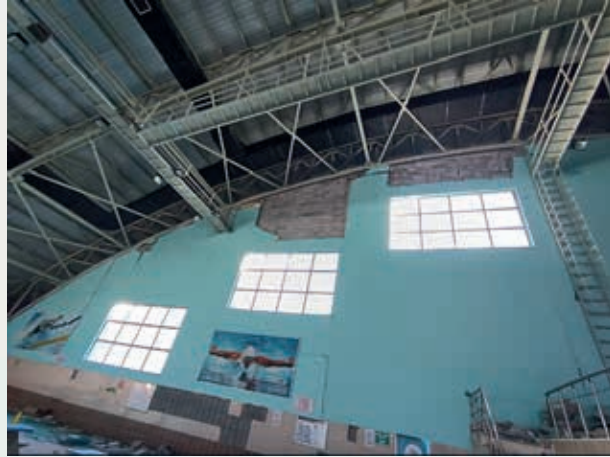
Şekil 3.52. Kalkan duvar hasarı
