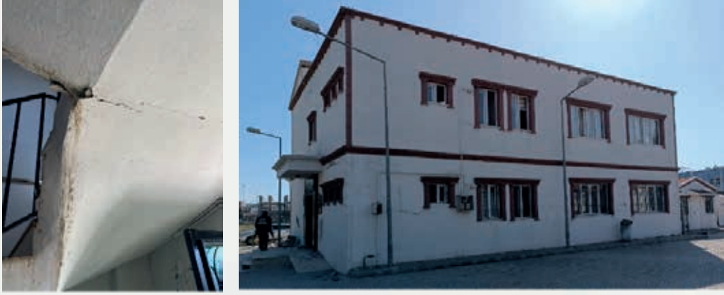
Şekil 3.51. Merdiven hasarı ve duvar hasarı
